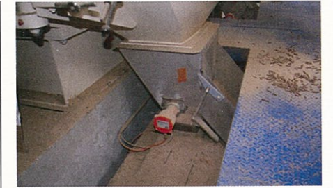
► Détecteur FIREFLY installé en sortie de presse chez EO2 / FIREFLY detector installed at the outlet of a press at EO2's (doc. BERTHOLD).
